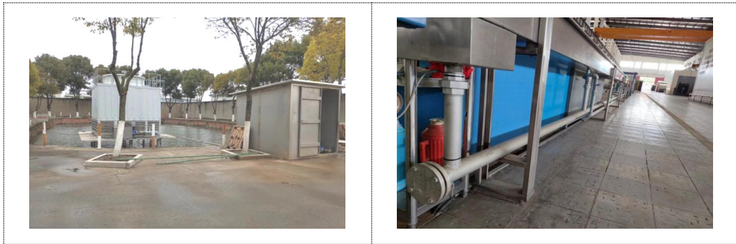
厂内雨水收集池
