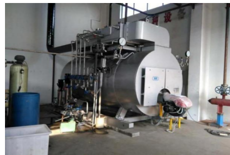
改造后燃气锅炉
