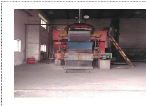
改造前燃煤锅炉
